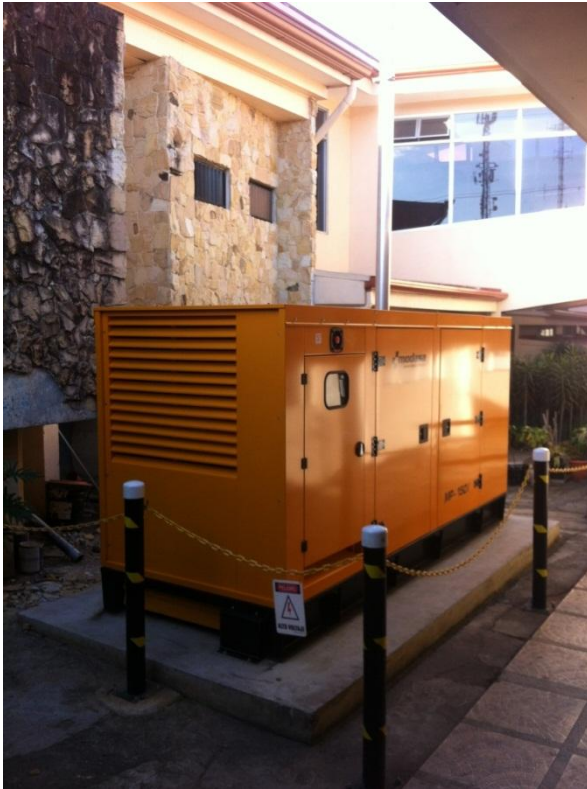
Planta Eléctrica instalada Marca: Modassa Potencia: 160 KVA
